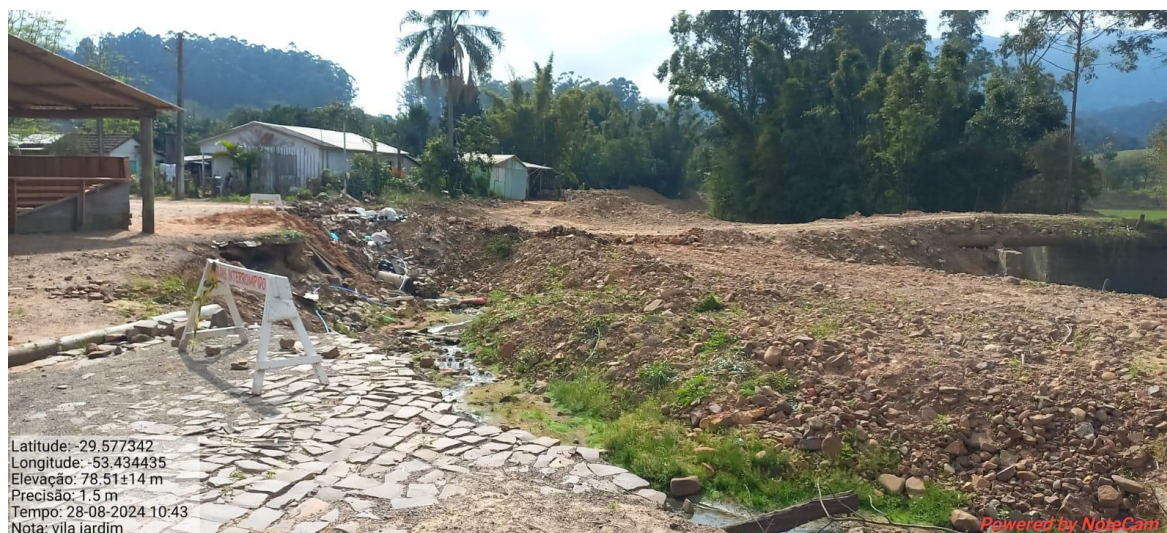
(fotos da estrutura danificada)
