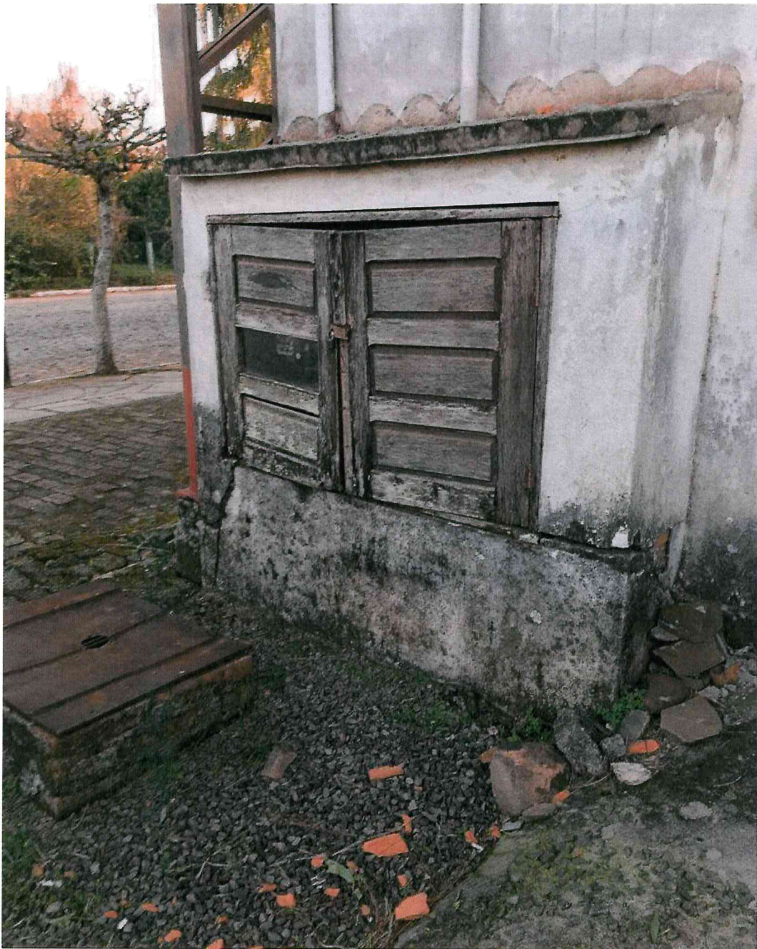
Fig.03 – Entrada de energia existente
