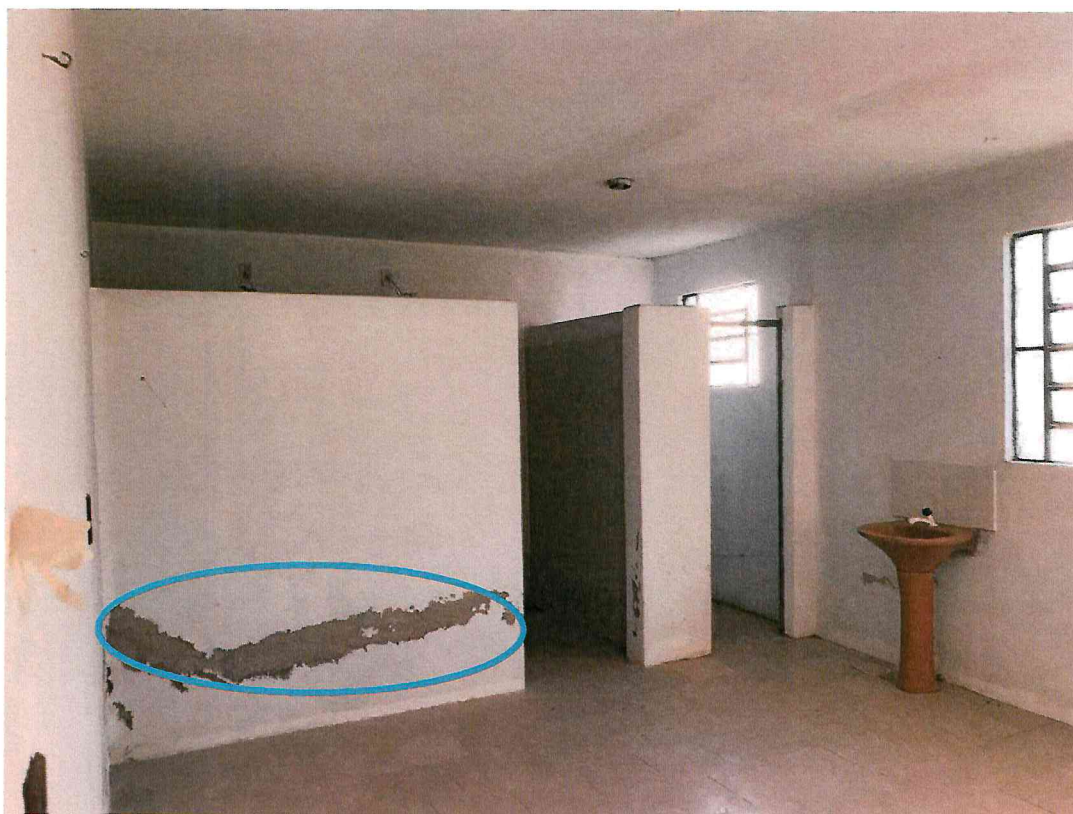
Fig.01 – área de degradação do revestimento.
